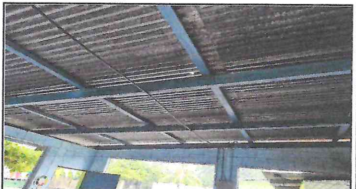
Foto 4: Estructura de soporte de madera de coco en mal estado
