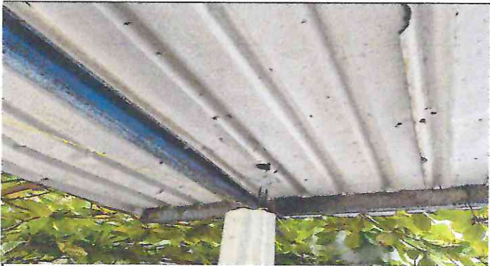
Foto 3: Estructura de soporte con daños provocados por la corrosión
