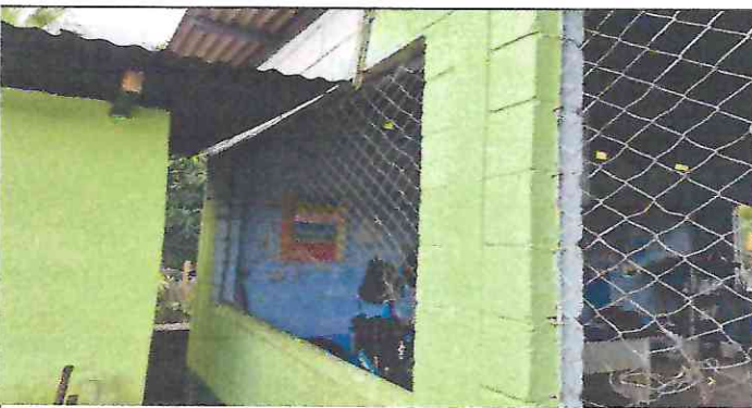
Foto 5: La estructura de metal de las ventanas con daños considerables
