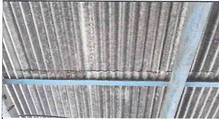
Foto1: Lámina con daños ocasionados por el salitre
