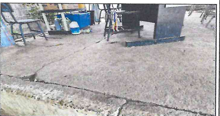
Foto 6: El piso de concreto en mal estado
